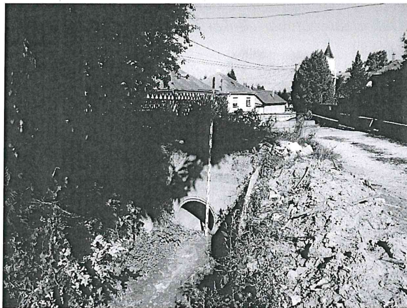
1. kép: az eltömődött csőátereszt és a kimosodt betonelemek
