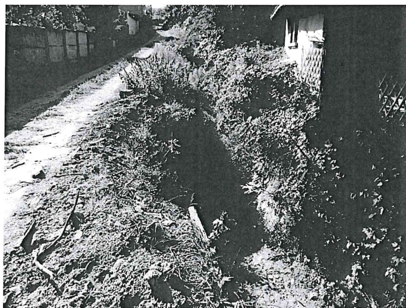
2. kép: a csőátereszt feletti kimosódott partfal és közút
